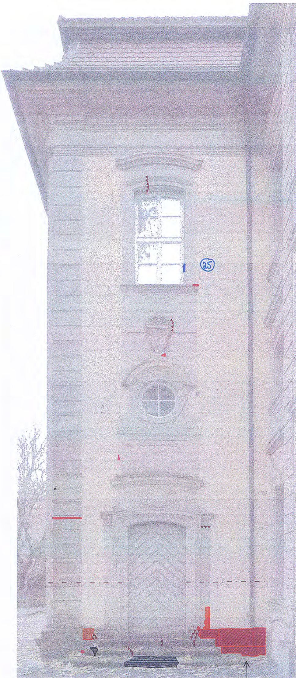
Schadenüberlagerung: -Abblättern -Gips- oder Sinterkrusten
