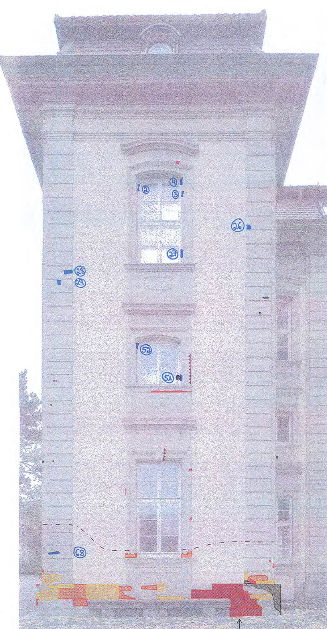
Schadenüberlagerung: -Abblättern -Gips- oder Sinterkrusten
